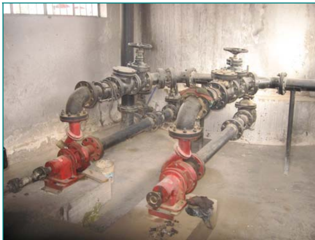
Foto N° 015 Vista de la Instalación Interior del Reservorio Gemelo R4A
