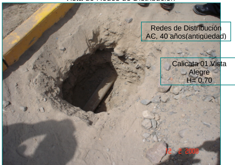
Foto N° 017 Vista de Redes de Distribución
