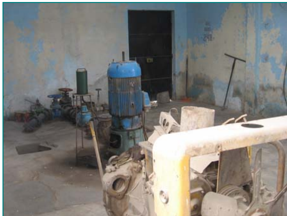
Foto N° 04 Vista del Interior de la Caseta de bombeo del Pozo Cajuca N°2
