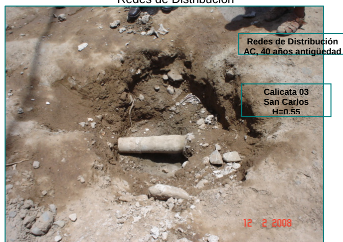
Foto N° 018 Redes de Distribución
