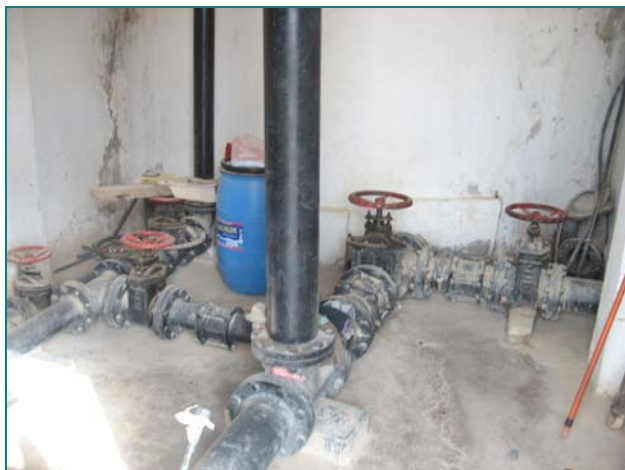
Foto N° 014 Vista de la Instalación Interior del Reservorio Gemelo R3A
